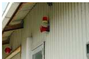
消防団詰め所屋外警鳴機
