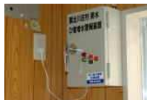
河川増水警報装置受信盤
