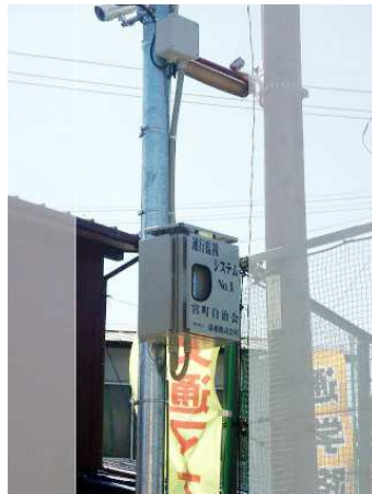
通行監視システム機器ボックス
