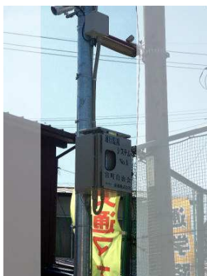
通行監視システム機器ボックス
